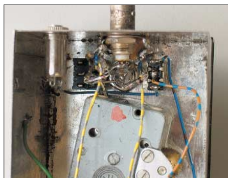
Bild 17: Ganz kurze Anschlüsse zu den Brückenelementen sind beim dritten Gerät ein Muss. Die Germaniumdioden sind in Kelchfedern gesteckt und nicht gelötet.
